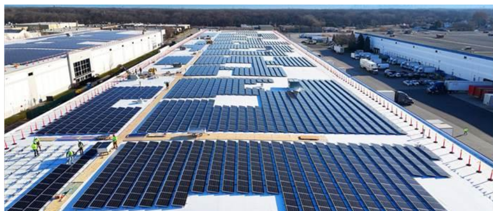
图 6：安博（Prologis）物流园区屋顶光伏系统
