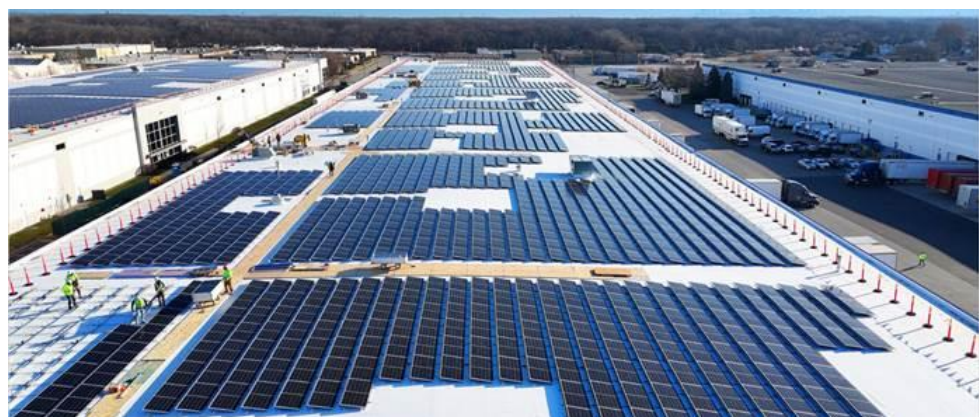
图 6：安博（Prologis）物流园区屋顶光伏系统
