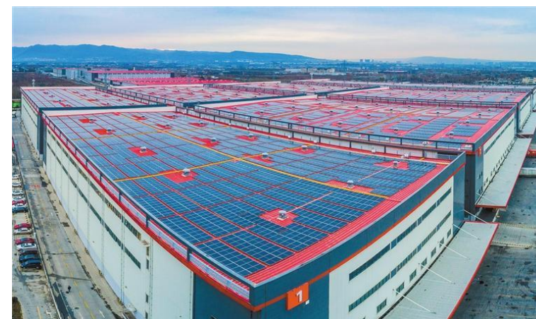
图 12：京东“亚洲一号”西安智能物流园屋顶光伏
