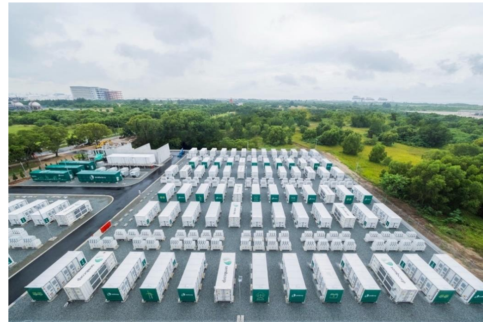
图 10：新加坡辅助储能系统
