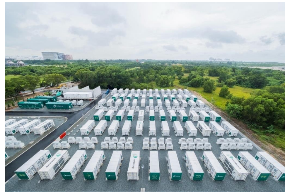
图 10：新加坡辅助储能系统
