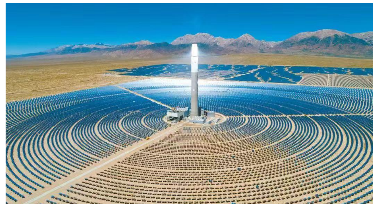
图 21：青海中控德令哈 50 兆瓦光热电站
